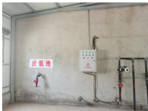
甘肃河西制药有限责任公司污水处理站
