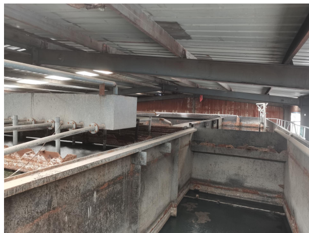
张掖市三维豆制品有限责任公司污水处理站
